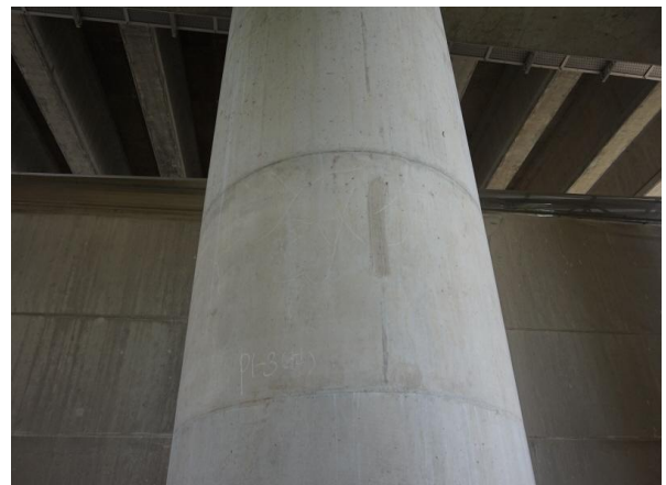
교각 망상균열 P1
