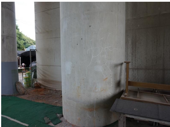
교각 망상균열 P1
