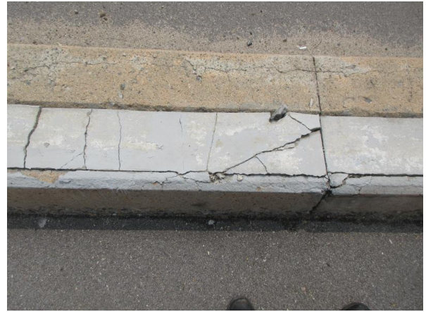
중앙분리대 보수부 박락 S4
